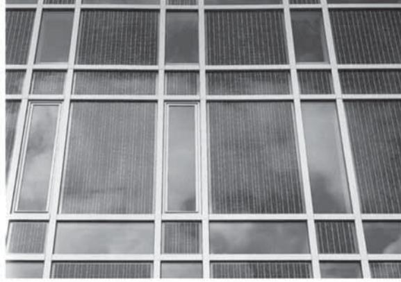
الشكل (11-10): واجهة فولتضوئية مجهزة بمنظومات فولتضوئية متعددة البلورة ونوافذ مرتبة على شكل لوحة الشطرنج (شوهدت في "ستادت ويرك آخن" (Stadtwerke Aachen)).
