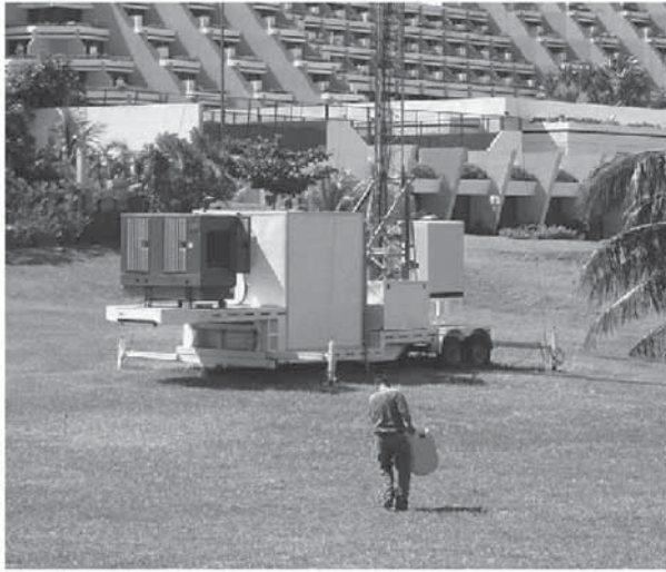
الشكل (5-1): مولد يعمل بالديزل لتزويد محطة تقوية هاتف خلوي 2 kW مع ضوءاء وغازات عادم في ساحة فندق بمدينة كانكون في المكسيك. ويجب حضور عامل التشغيل كل 12 ساعة لأعمال إعادة التعبئة - فلماذا لا يُستخدم مولد فولتضوئي بدلاً عن ذلك؟
